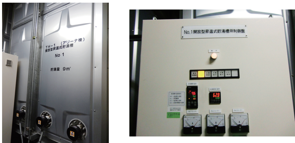
図表3 給湯用のお湯を溜める槽と制御盤
