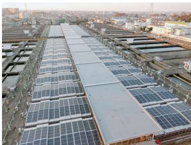
図表 2 前段ろ過池の太陽光パネル
