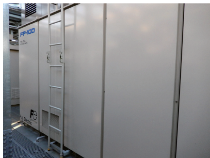
100kW の燃料電池
